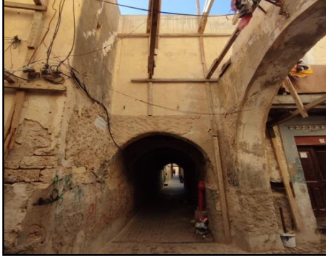
شكل رقم (2): العقود النصف دائرية المتتابعة ساباط زنقة حواء عليجة المصدر: تصوير الباحثة
